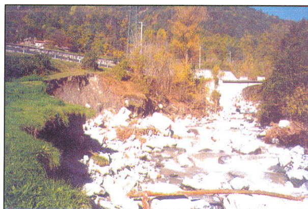
Foto 2 Profonda erosione spondale in destra orografica del T.Marmore.
