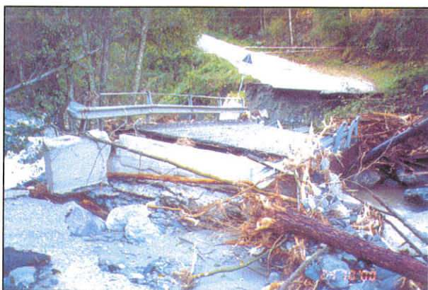
Foto 1 Ponte sul Marmore distrutto dall'alluvione 2000
