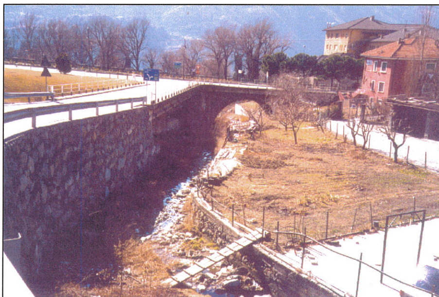
Foto 29 T. Biègne immediatamente a monte della confluenza con il T. Grand-Valey; si può osservare un restringimento di sezione e una riduzione dell'altezza dell'argine destro.
