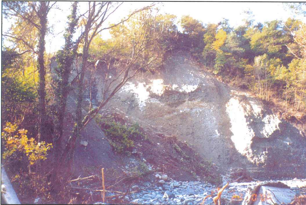
Foto 8 Frana per erosione al piede del versante originatasi in destra orografica del Torrente Marmore.
