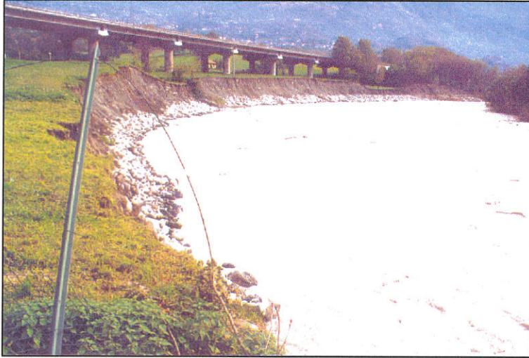
Foto 15 Erosione spondale in corrispondenza della vasca del depuratore (24 Ottobre 2000)
