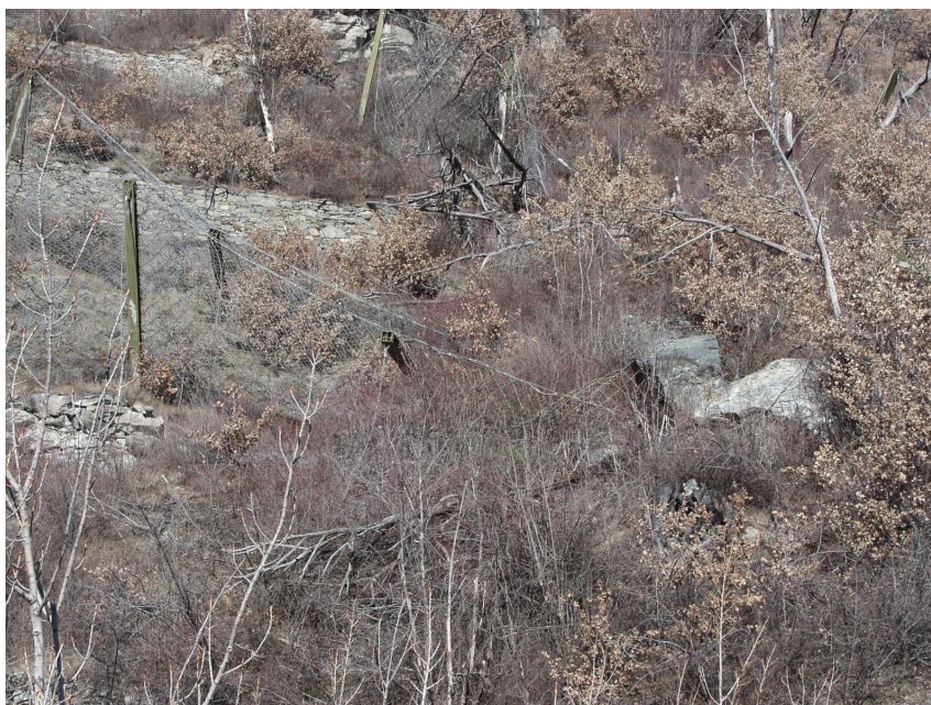
FOTO 8_ Barriera paramassi di quota: 605m slm presente sul lato destro del colatoio a monte del vallo a quota maggiore quota 600m slm_ situazione attuale
